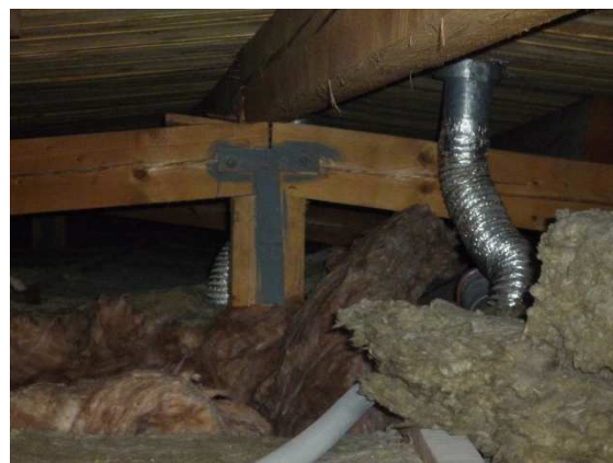
Pohľad na VZT odvetranie sociálnych zariadení, rozhádzanú tepelnú izoláciu a chráničky elektro
