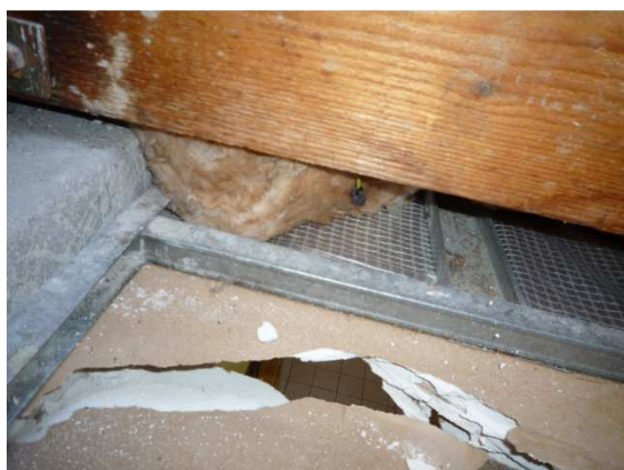
Pohľad na spodnú časť výlezu, rozpadnutý pohľad v soc. zariadeniach. Je vhodné ho rozšíriť aspoň na veľkosť výlezu na streche a pritom musí byť tesný voči vodným parám (musí tvoriť aj parozábranu! Neporušenú parozábranu je vidieť mimo výlezu na bežnej ploche kde ale chýba tepelná izolácia
