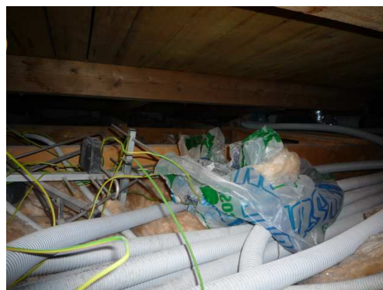
Pohľad na spleť káblov na tepelnej izolácii...
